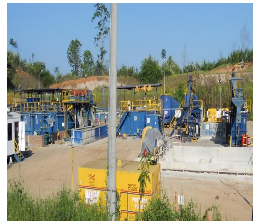
Fotografía 7-10 Zona de manejo de cortes y lodos de perforación
