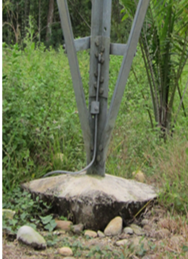
Fotografía 2.2.2-14 Conexión al sistema puesta a tierra de una torre de transmisión
