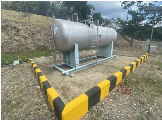
Contenedor de Diésel
